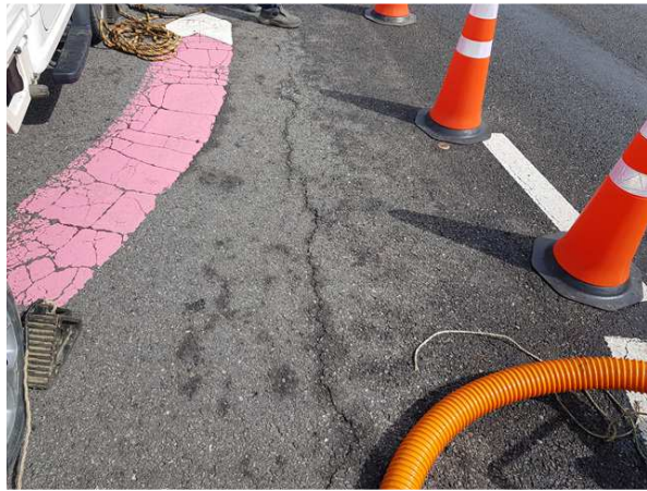
내용 포장부 아스콘균열
