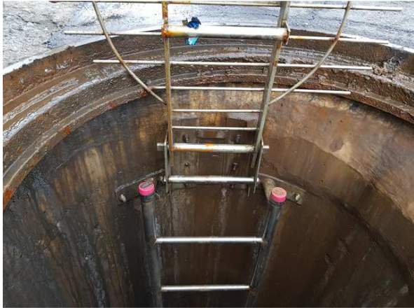
내용 안전 사다리 앵커볼트 파손
