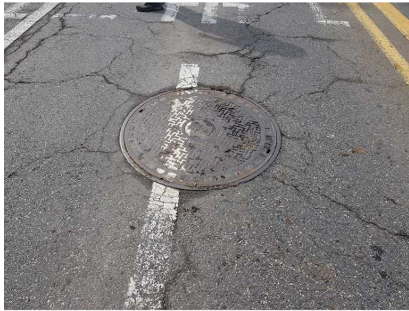
내용 포장부 아스콘 망상균열
