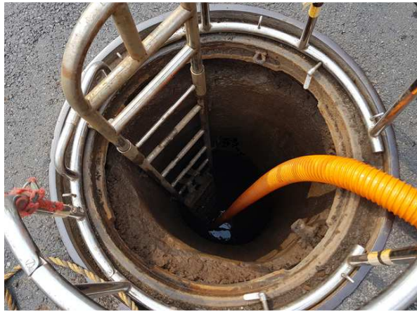
내용 안전 사다리 상태양호
