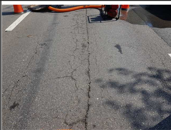
내용 포장부 아스콘 균열
