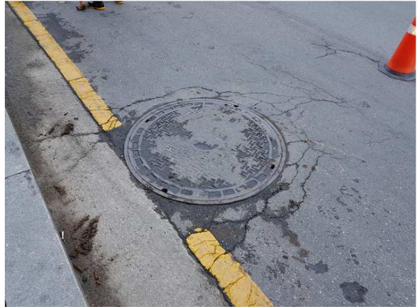
내용 포장부 아스콘 망상균열
