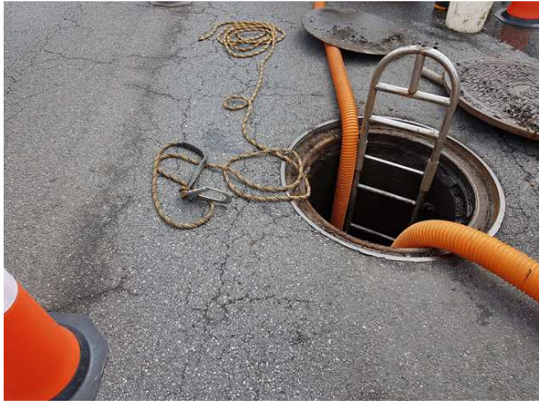
내용 포장부 아스콘균열
