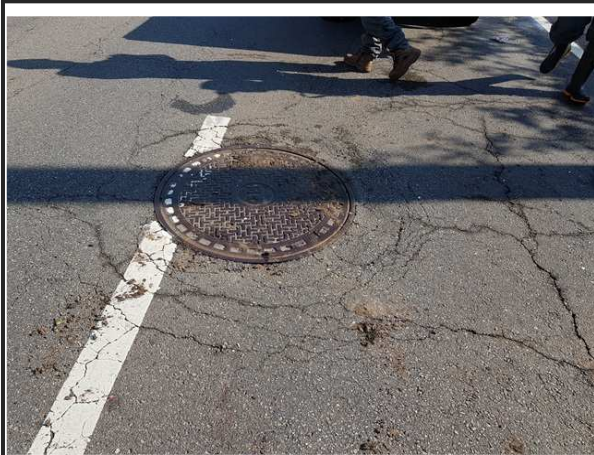
내용 포장부 아스콘 망상균열
