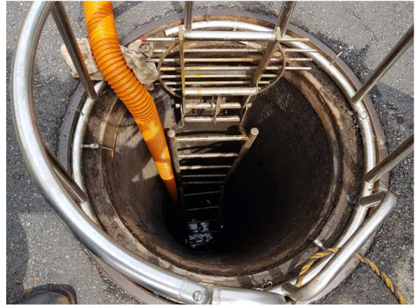
내용 안전 사다리 상태양호
