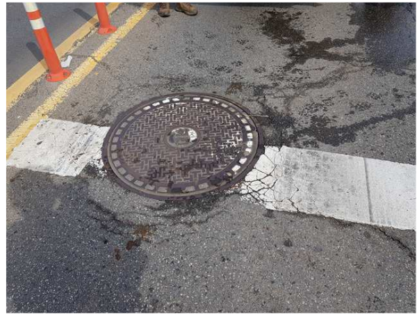
내용 포장부 아스콘 망상균열
